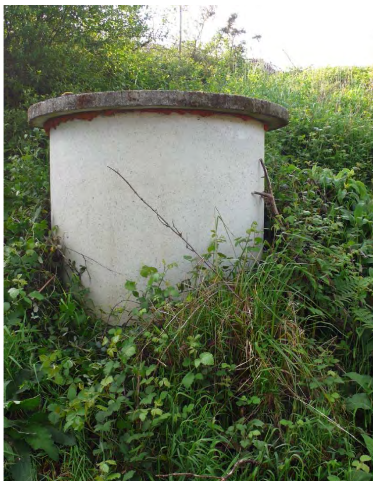
Caja de captación.
