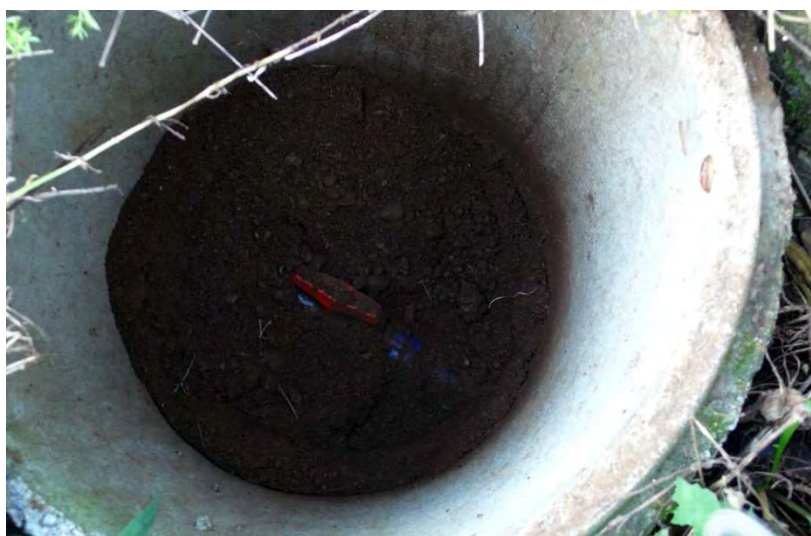
Detalle de la arqueta con la llave de paso de la red de distribución.
